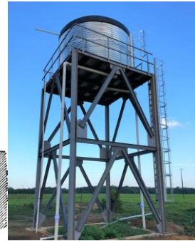
Figura3: Depósito de agua.
